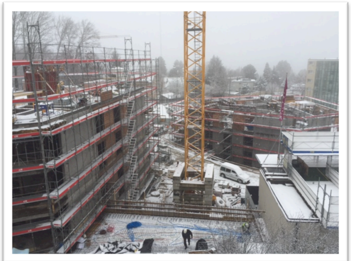
Bâtiments C et D avec au premier plan le toit de la future cafétéria des ateliers
